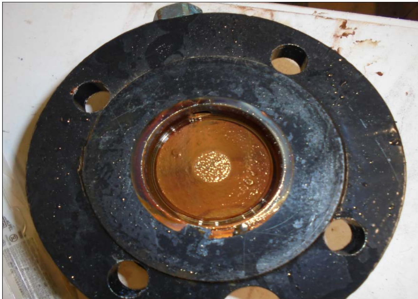
Fig 7 Booster Set 2 (Pump number 5 NRV)
